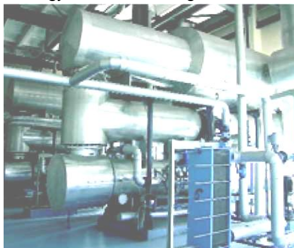
Рисунок 2. - Зал теплообменного оборудования
