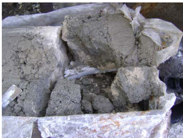
Рис. 3 Общий вид разрушенного бетона внутри трубы
