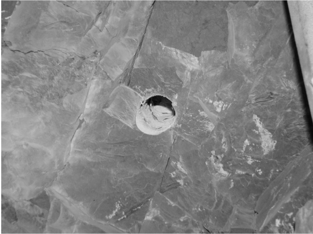
Рис. 6. Состояние поверхности кровли грузового ходка уклона пл. m_4^0 гор. 450 м вокруг шпура с НРВ после демонтажа деформированной рамы крепи
