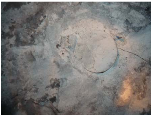
Рис. 3 – Начало разрушения – рост трещины
