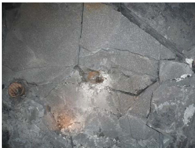
Рис. 7 – Общий вид разрушенной породы в забое подрывки при разделке габаритов рельсового пути.
