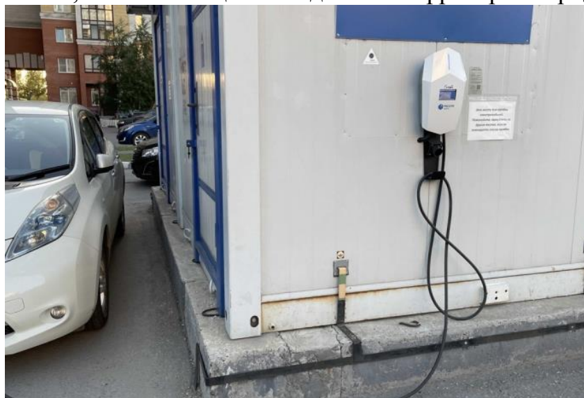
Рис. 1. Электроавтозаправочная станция в спальном микрорайоне
