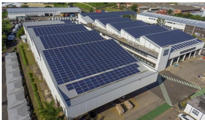
Рис. 1. Солнечные коллекторы на крыше Российского оборонного предприятия АО «ВПК «НПО Машиностроение»
