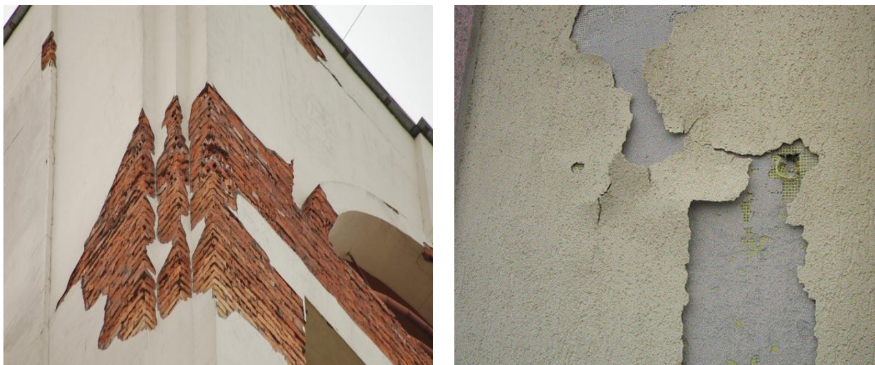
Рисунок 5 – Разрушение отделки фасадов зданий
