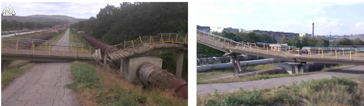
Рисунок 6 – Повреждение несущих элементов сооружения
