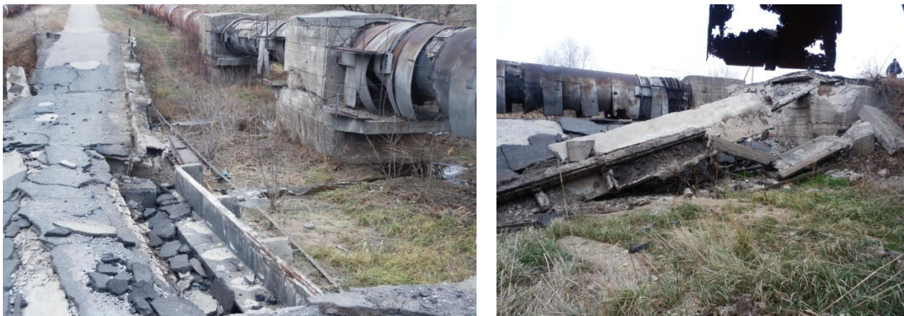
Рисунок 5 – Повреждение несущих элементов сооружения
