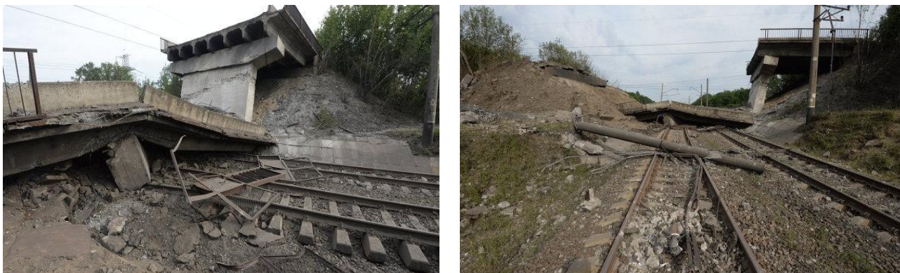
Рисунок 7 – Повреждение несущих элементов путепровода
