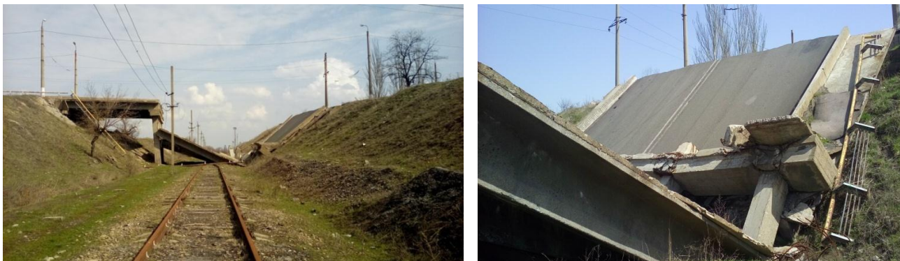
Рисунок 2 – Повреждение несущих элементов сооружения
