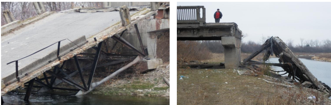
Рисунок 3 – Повреждение несущих элементов моста
