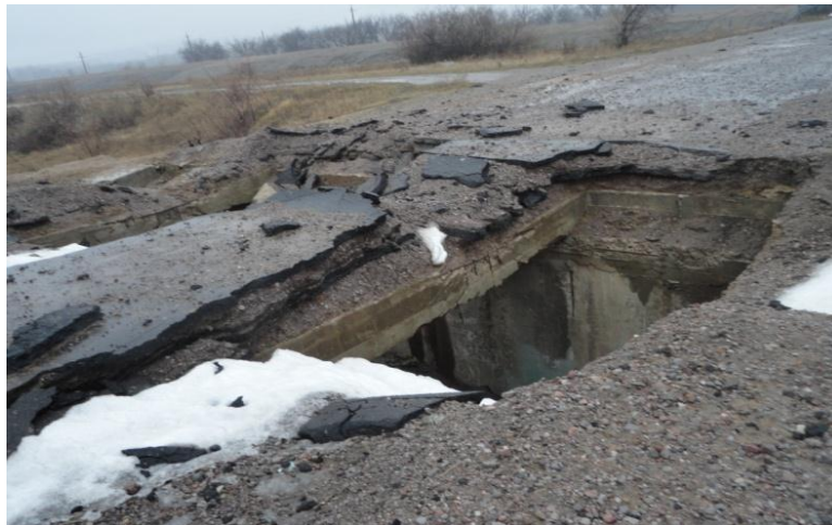
Рисунок 4 – Повреждение несущих элементов сооружения
