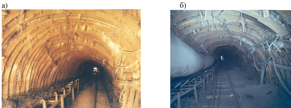
Рисунок 5 – Общее состояние крепи конвейерного штрека 4-й западной лавы пласта m_3 шахты им. Е.Т.Абакумова на участках с анкерной крепью (а) и при использовании двойной продольно-балочной крепи усиления (б)
