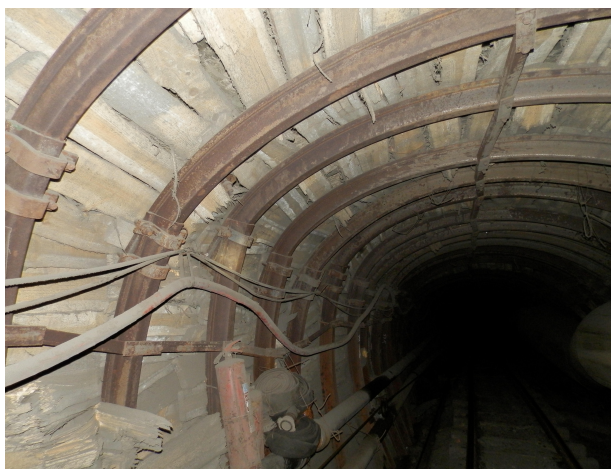
Рис. 3 – Деформации крепи со стороны боков выработки
