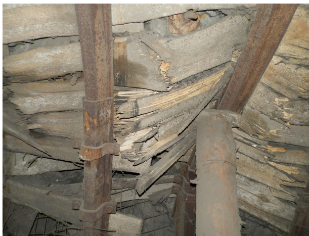
Рис. 1 – Образование складок в кровле выработки
