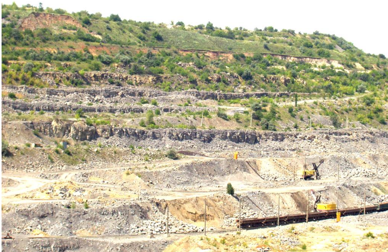
Рисунок 1 - Деформация № 6 на южном борту карьера «Доломитный» филиала №14 «Докучаевский флюсо-доломитный комбинат» ЗАО «Внешторгсервис»
