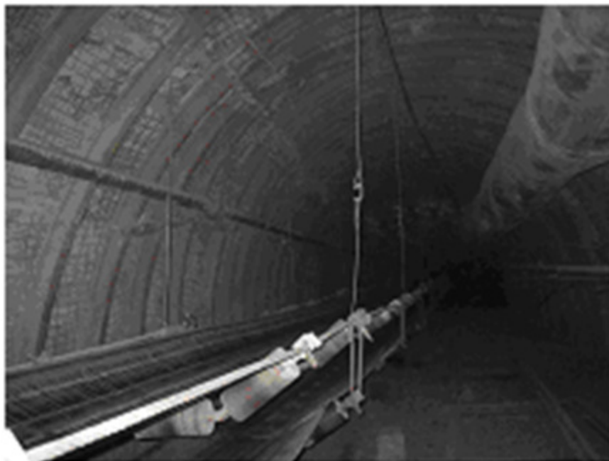
Рис. 3 – Общее состояние западного полевого конвейерного штрека на расстоянии 200 м от сопряжения с наклонными выработками
