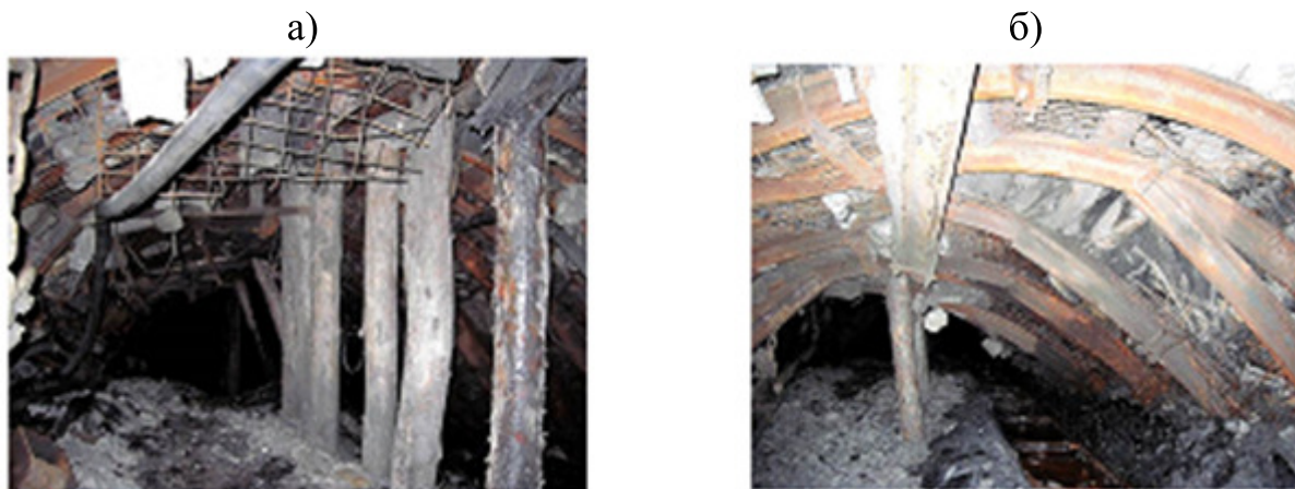
Рис. 2 – Состояние конвейерного штрека 8-й западной лавы пласта m_3 при использовании деревянной крепи усиления на расстоянии: 30 м (а) и 60 м (б) вслед за очистным забоем с выдавливанием почвы, разрывом замков и разрушением элементов крепи
