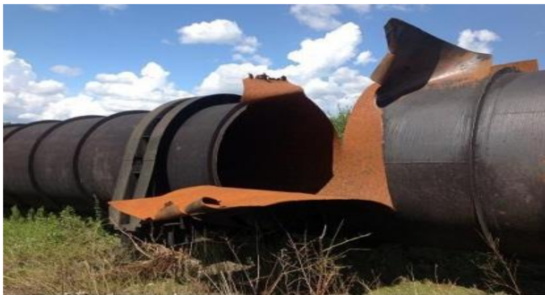
Рисунок 1 – Разрушенный участок канала «Северский Донец-Донбасс»
