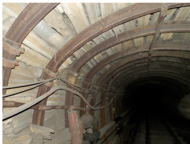
Рис. 3. Деформации крепи со стороны бока выработки
