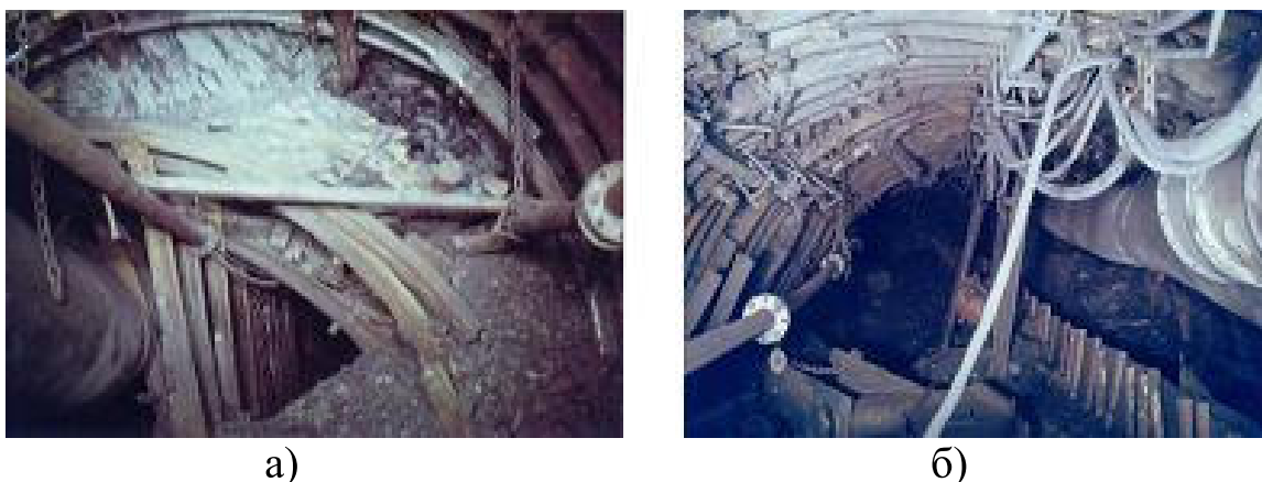
Рис. 3. Состояние конвейерного штрека без крепи усиления (а) при перекреплении на расстоянии 220 м за забоем 2-й западной лавы; и с продольно-балочной крепью усиления на расстоянии 230 м за очистным забоем (б)
