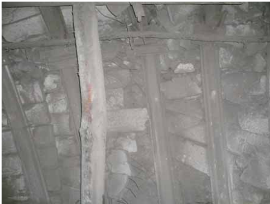
Рис. 2. Состояние крепи в западном магистральном откаточном квершлагге гор. 493 м шахты «Трудовская» ГП ДУЭК
