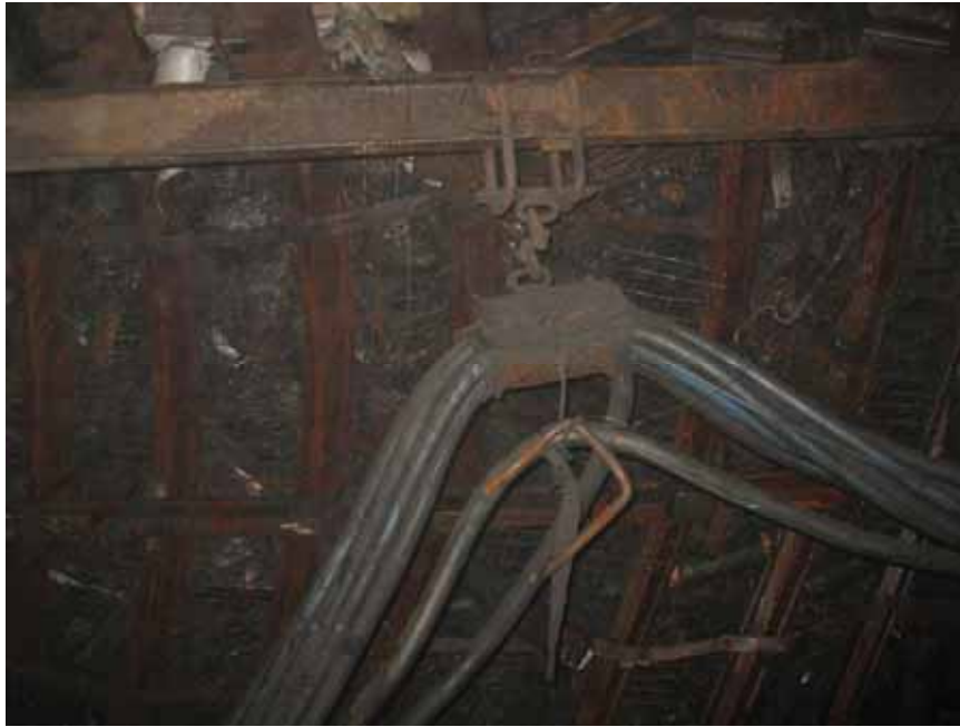
Рис. 1. Состояние крепи в конвейерном штреке 5 восточной лавы пл. т 3 гор. 915 м в условиях шахты «Щегловская-Глубокая» со стороны массива
