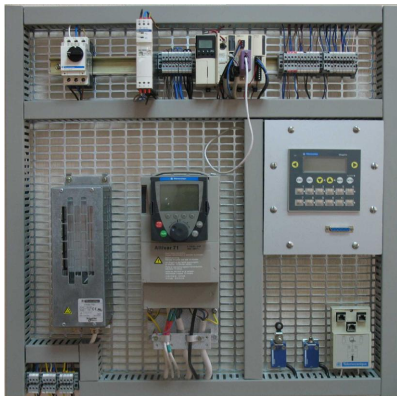
Рисунок 1 – Стенд № 1 для изучения систем автоматизации и регулируемого электропривода
