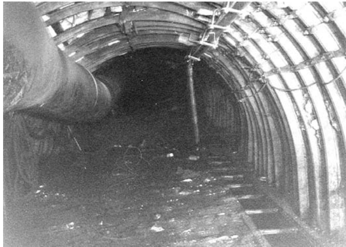
Рис. 2. Одинарная продольно-балочная крепь усиления в опережающей части конвейерного штрека 2-й восточной лавы пласта h_6^1 уклонного поля центральной панели
