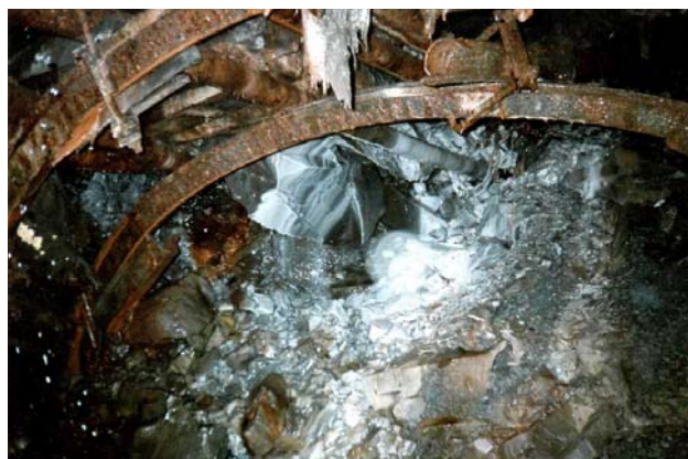
Рис. 3 – Вывалообразование в зоне пересечения вентиляционного штрека №1 с разрывным нарушением
