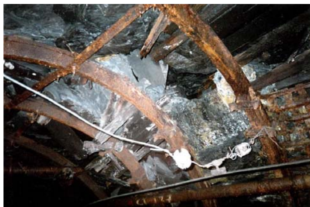
Рис. 2 – Фрагмент аварийного состояния вентиляционного штрека №1 пл. h_{10}
