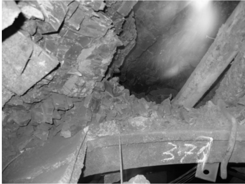
Рис. 4. Общий вид «купола» вывала пород над верхняком крепи конвейерного штрека 8 западной лавы пл. т 3 шахты им. Е.Т. Абакумова
