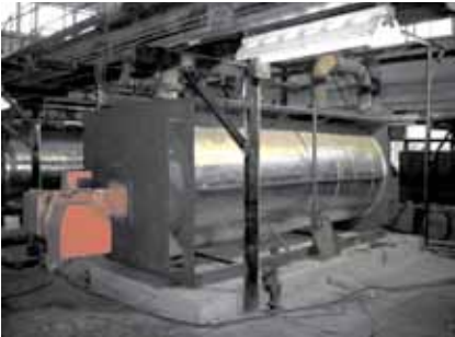
Сучасний котел КОЛБІ-5000 з ККД 94% на котельні м-ну «Сонячний»
