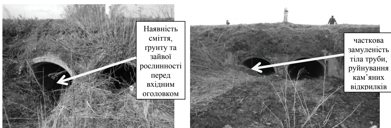
а) б) Рис. 9. Труба залізобетонна №6 ПК11+848: а) вхідний оголовок; б) вихідний оголовок
