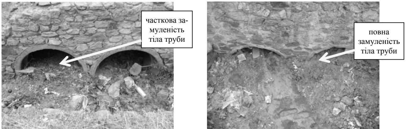
а) б) Рис. 5. Труба залізобетонна № 13 ПК33+370: а) вхідний оголовок; б) вихідний оголовок
