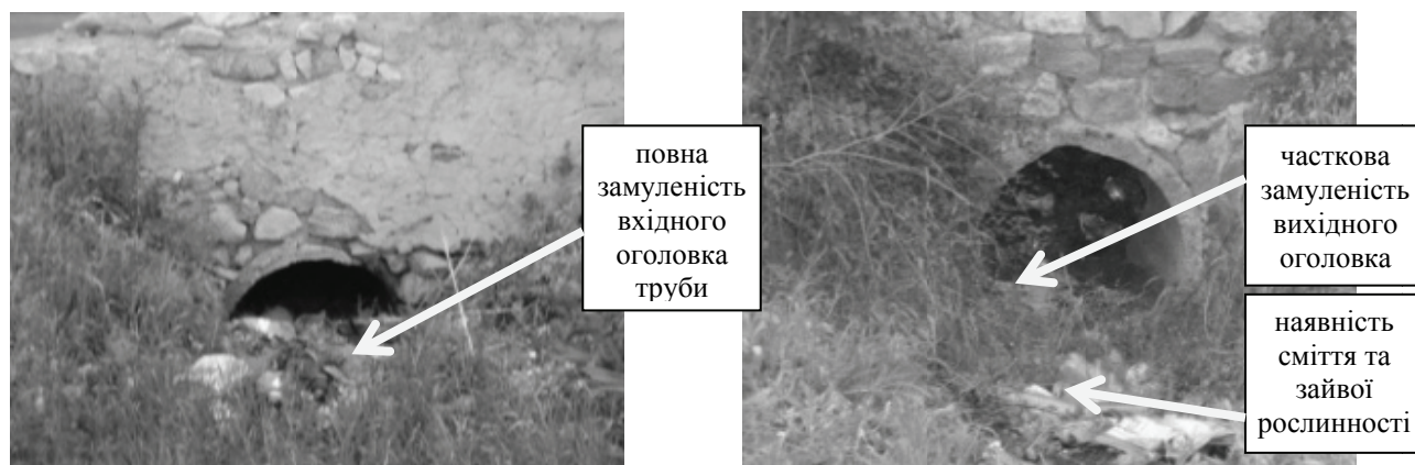
а) б) Рис. 8. Труба залізобетонна №18 ПК41+200: а) вхідний оголовок; б) вихідний оголовок
