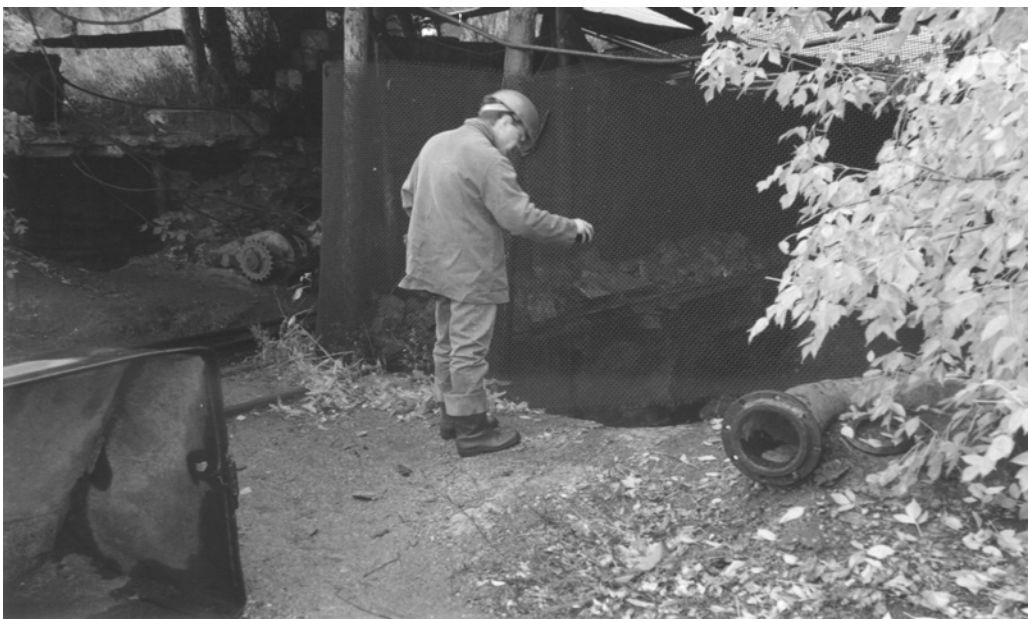
Фото 2 – Провал над вспомогательным наклонным стволом ш. № 20 «Постниковская» ПО «Шахтёрскантрацит»
