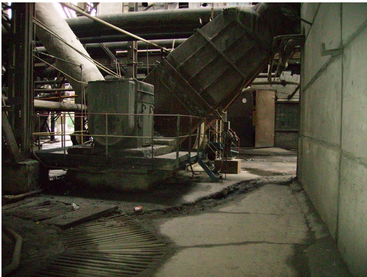
Рисунок 21 – Загальний вид установки вентилятора
