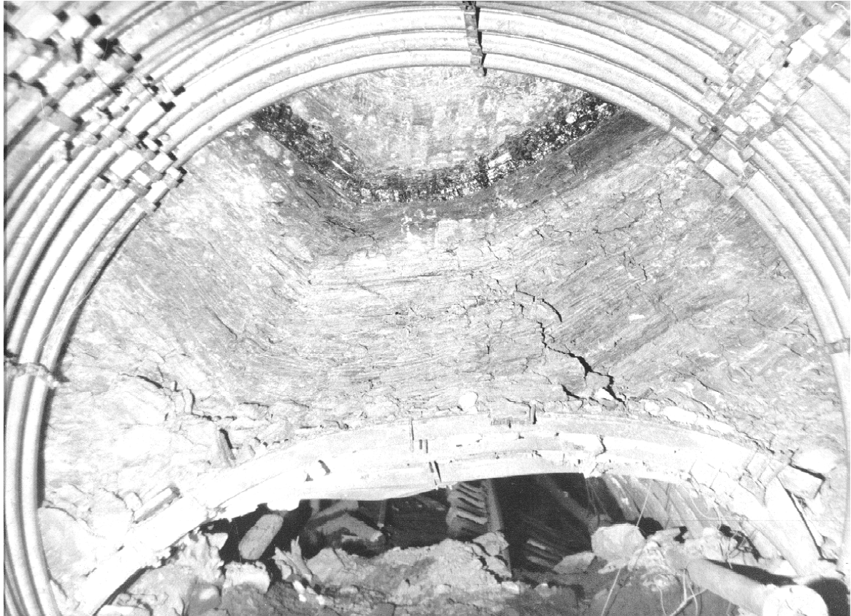
Рис. 4. Состояние расщетки полевого штрека на шахте «Западнодонецкая» ГХК «Павлоградуголь» [6]
