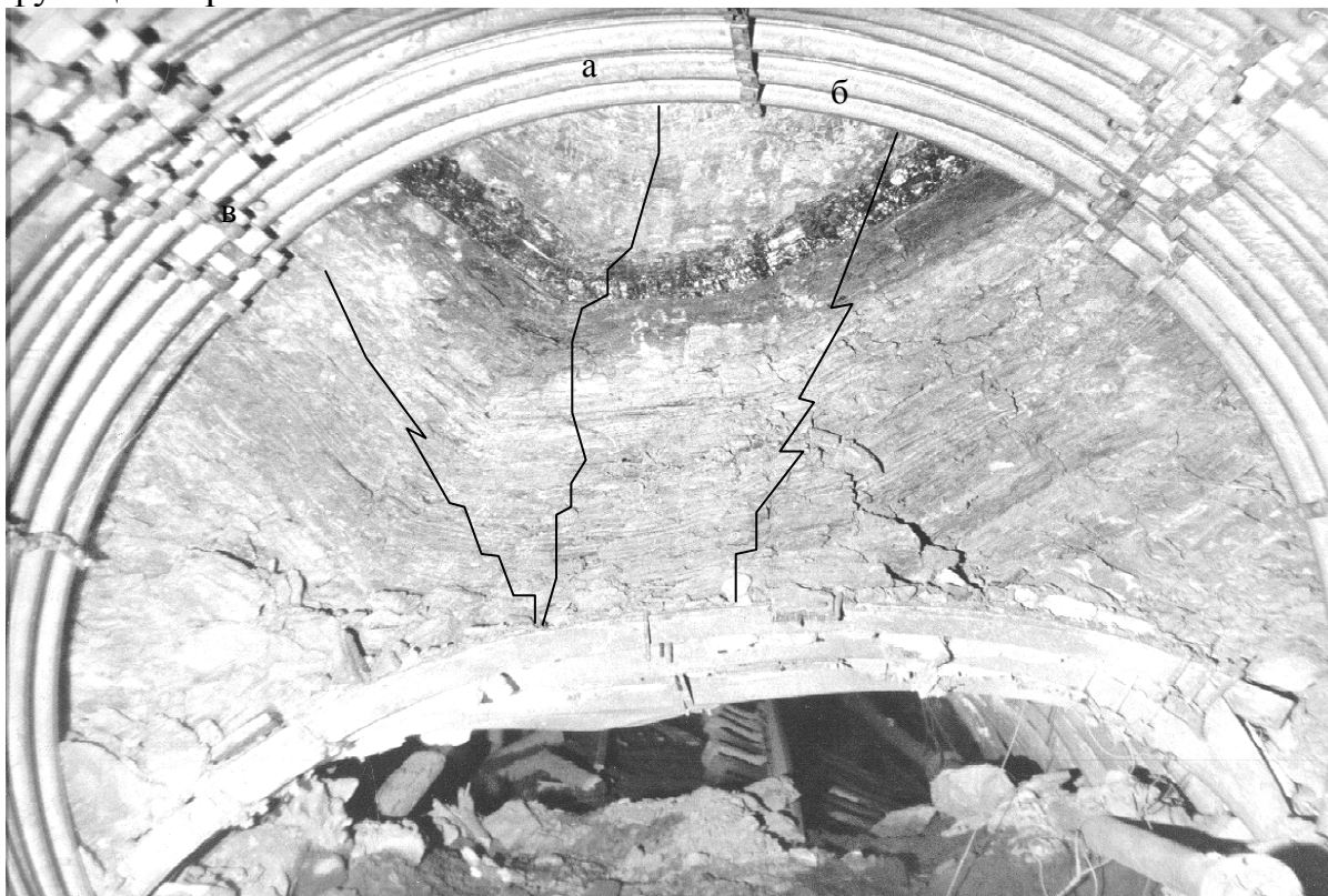
Рис. 2. Состояние расщелки штрека на шахте «Западнодонецкая» ГХК «Павлоградуголь» [5]
