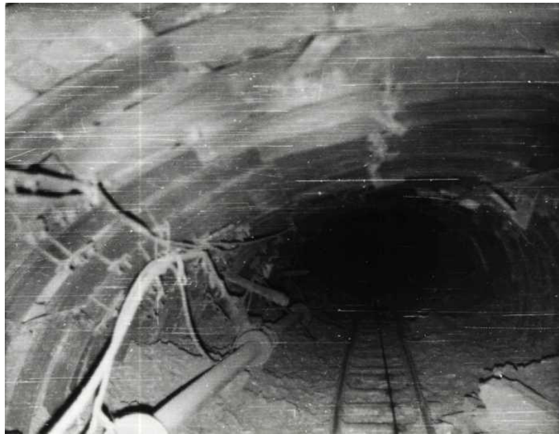
Рис. 1 – Состояние ходка механической доставки третьей ступени пласта k_8 шахты им. Челюскинцев ГП "ДУЭК" к моменту начала ремонта
