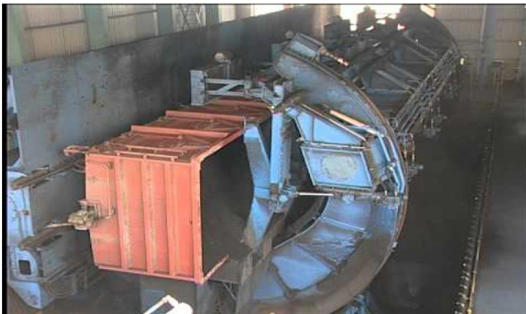
Рис 10.4 – Вид работающего вагоноопрокидывателя.
