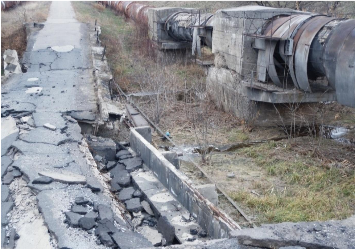
Рисунок 5 - Разрушение моста канала СДД на ПК 926
