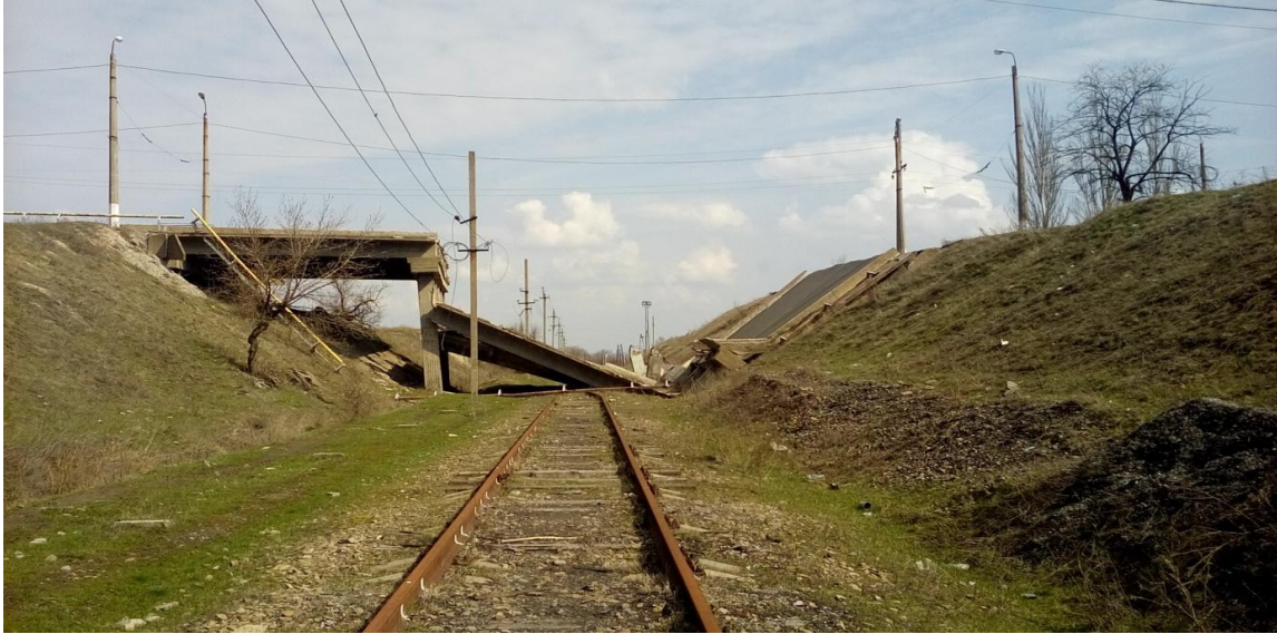
Рисунок 2 - Разрушение путепровода №2 по ул. Б. Макухи
