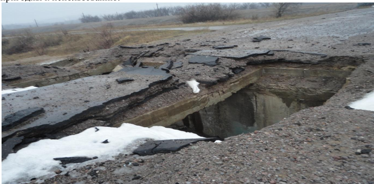
Рисунок 4 - Разрушение моста через канал СДД на ПК833+80 по ул. Венской
