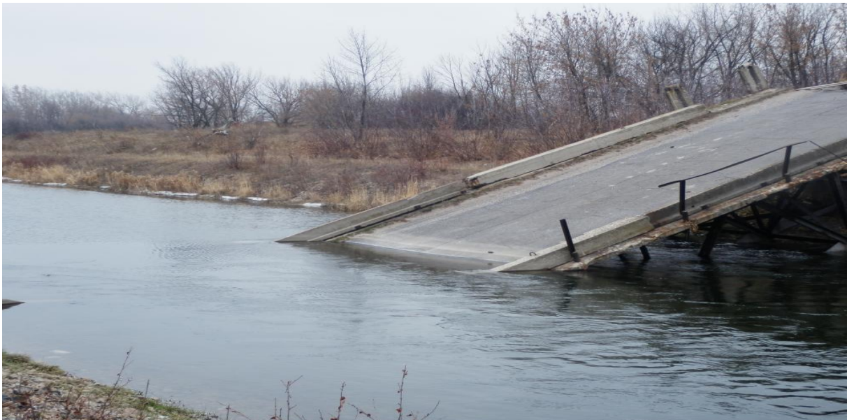
Рисунок 3 - Разрушение моста через канал СДД на ПК997+16,2
