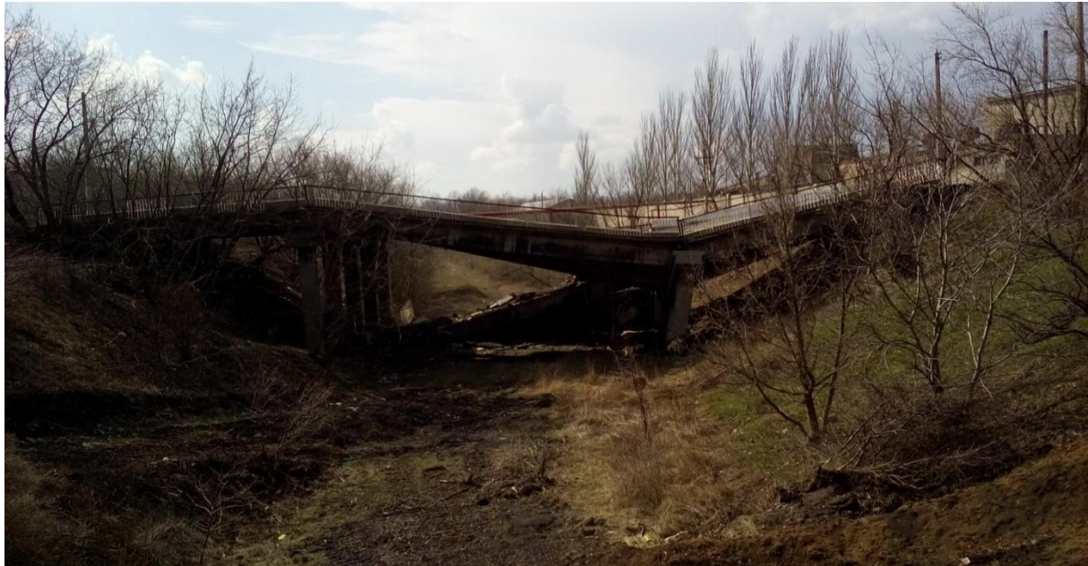
Рисунок 1 - Разрушение путепровода №2 по ул. Козлова
