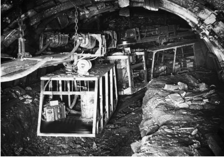
Рис. 15. Общий вид шахтной подвесной монорельсовой дороги с локомотивом на откаточном квершлагге l_8^1 - m_2 горизонта 1550 м и ходке №1 пласта m_2 шахты «Горняк»
