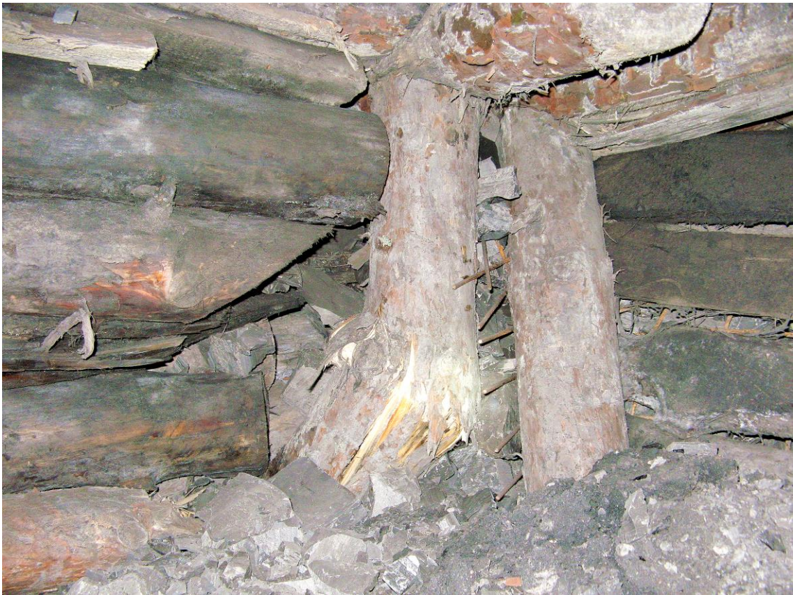
Рисунок 1.12 – Общий вид деформирования элементов деревянной крепи вследствие расползания бутовой полосы
