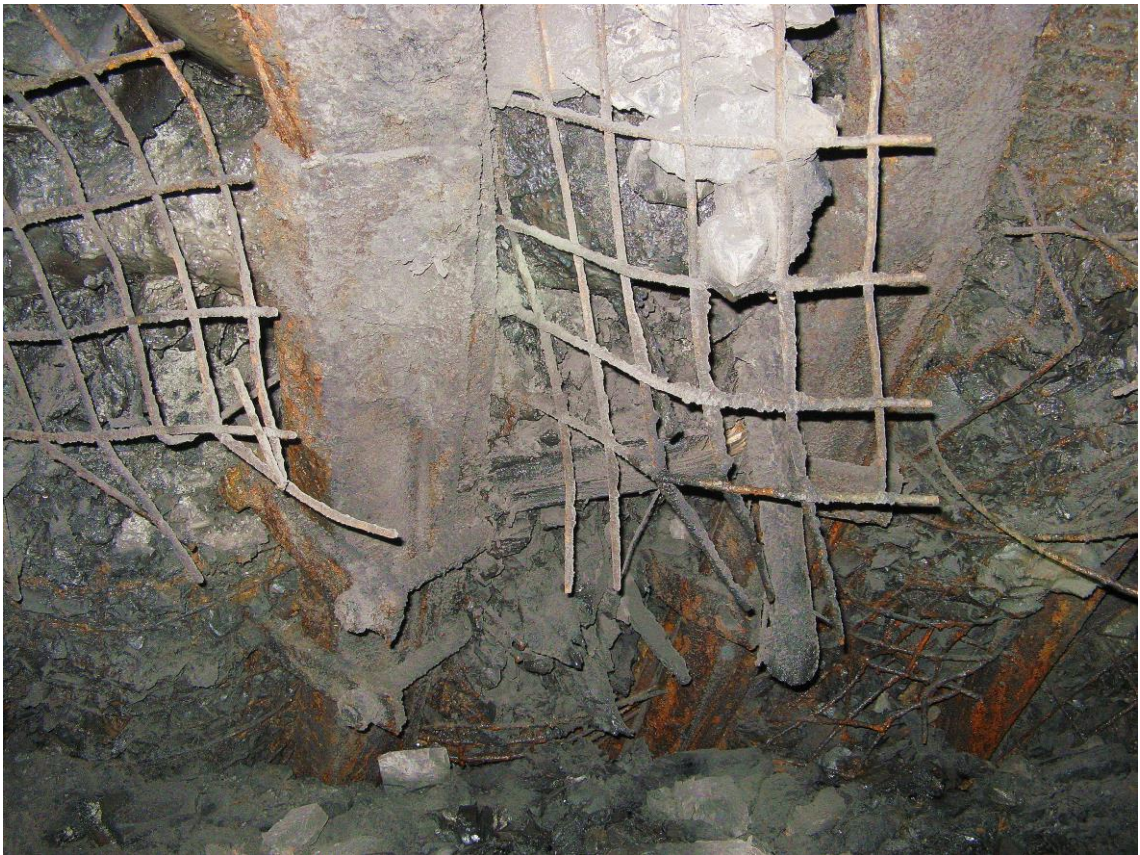
Рисунок 1.4 – Общий вид крепи выработки в местах капежа воды из кровли
