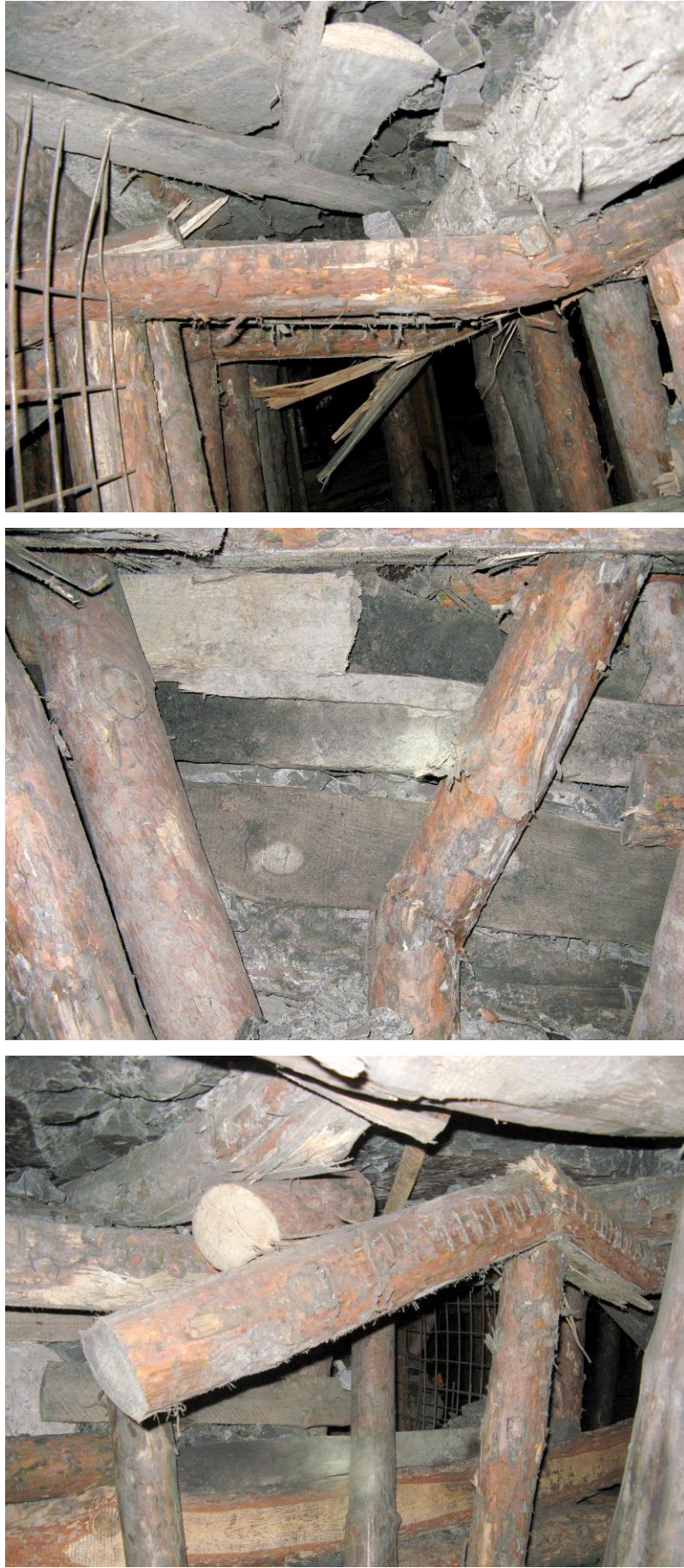
Рисунок 1.11 – Общий вид деформирования элементов деревянной крепи вследствие некачественной их установки
