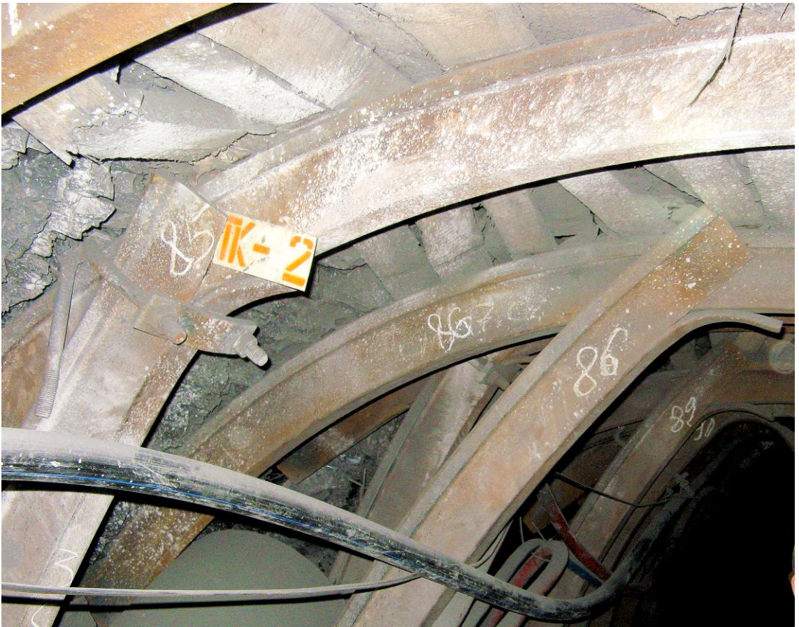
Рисунок 1.7 – Общий вид крепи выработки в местах разрывов замковых соединений
