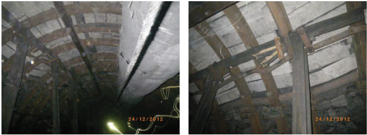
Рис. 3. - Состояние конвейерного штрека 11-й восточной лавы пласта k_3 при использовании продольно-балочной крепи усиления
