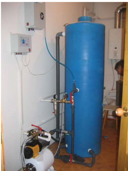
Рис.1. Установка озono-сорбционной очистки воды производительностью 2 м 3 /час
