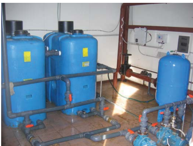
Рис.2. Установка озono-сорбционной очистки воды производительностью 15 м 3 /час
