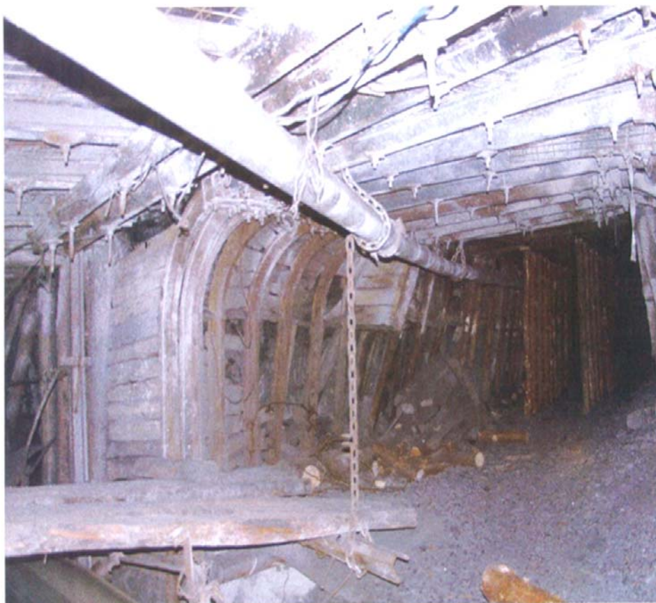
Рис.6. Состояние сопряжения монтажного ходка с конвейерной выработкой на момент окончания наблюдений
