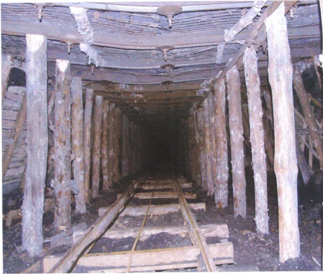
Рис.7. Состояние центральной части выработки на момент окончания наблюдений
