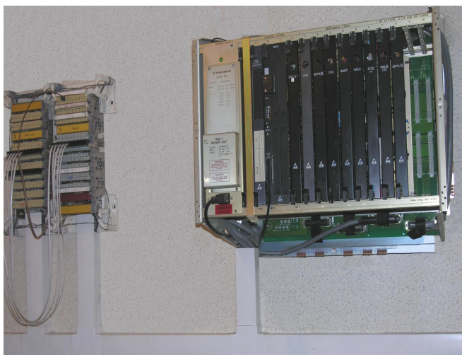
Стенд лаборатории автоматической коммутации базе оборудования Coral
