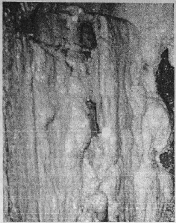
Рис. 2. потужна карбонатна кірка на кріпленні колодязя №8 ДШС №27
