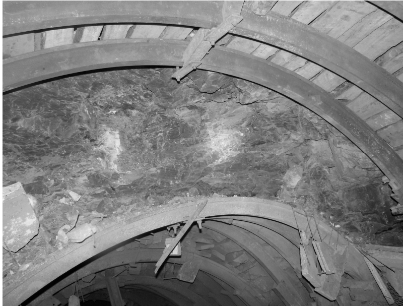
Рис. 6. Общий вид кровли грузового ходка уклона пл. m_4^0 гор. 450 м после демонтажа деформированной рамы крепи на экспериментальном участке
