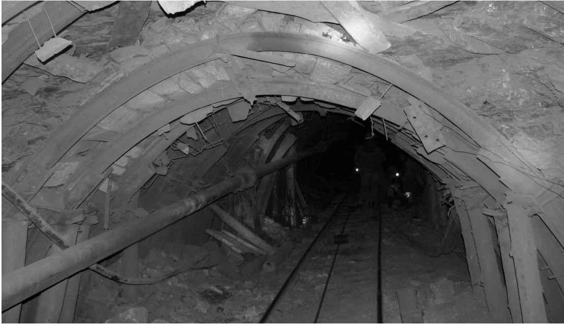
Рис. 2. Общий вид ходка до перекрепления
