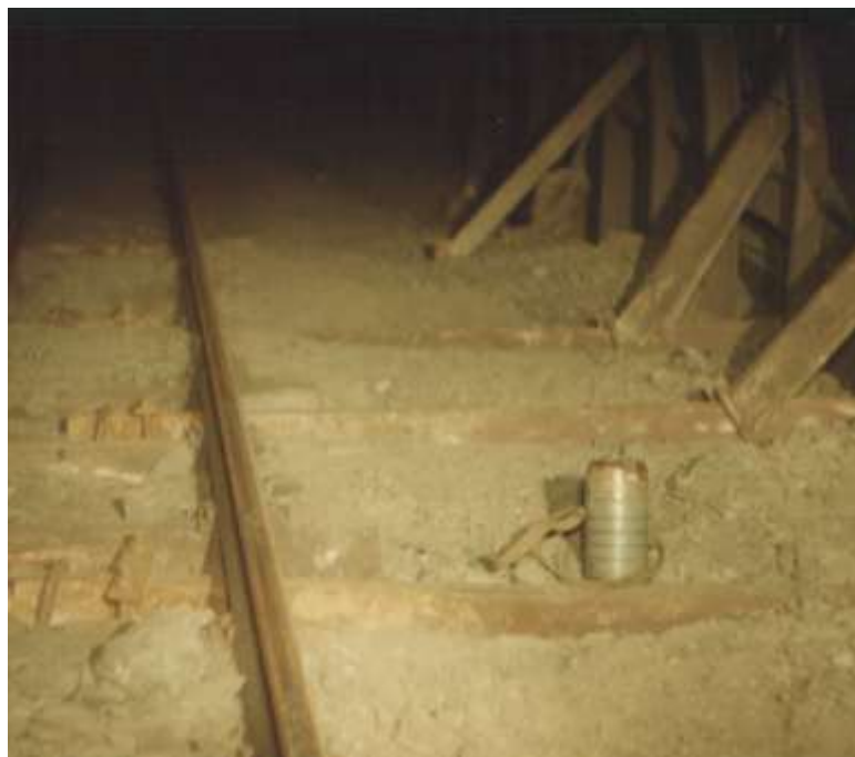
Рис. 7. Размещение металлических лежней и опорных стоек по почве конвейерного штрека 7-ой восточной лавы пласта l_8^1
