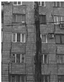
Деформации зданий в аномалиях СГДК-А по ул. Розы Люксембург
